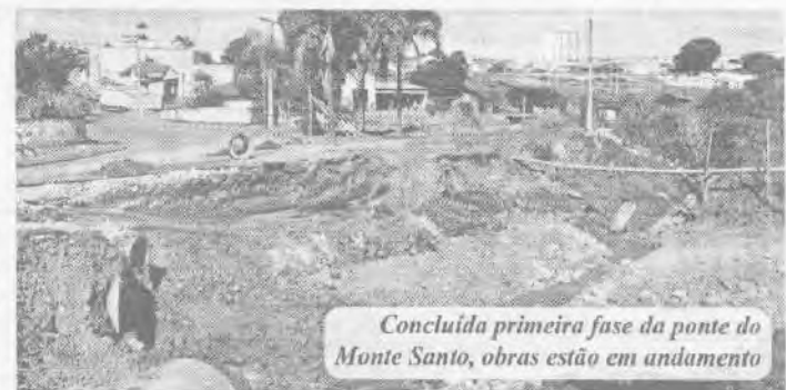
Córrego Monte Santo foi desassoreado e aguarda obras para canalização.
