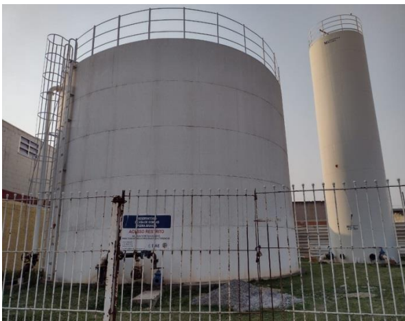
ITEM 7/ITEM 8 -Reservatório Pedra Branca I 620m 3 e II 110 m 3 Rua Sigilfredo Grimaldi,79
