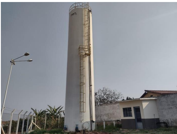
ITEM 12-Reservatório Jd. dos Lagos 200m 3 Rua Jose Amauri Bortolotto, 900
