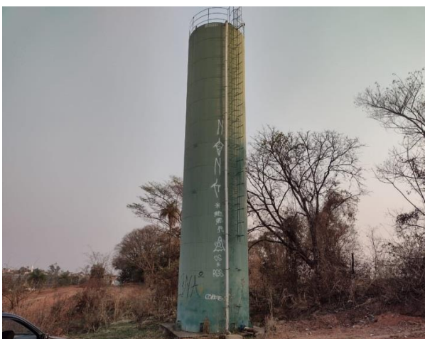
ITEM 15- Reservatório Cidade Jardim 200m 3 Rua Orioaldo Porfirio, s/n
