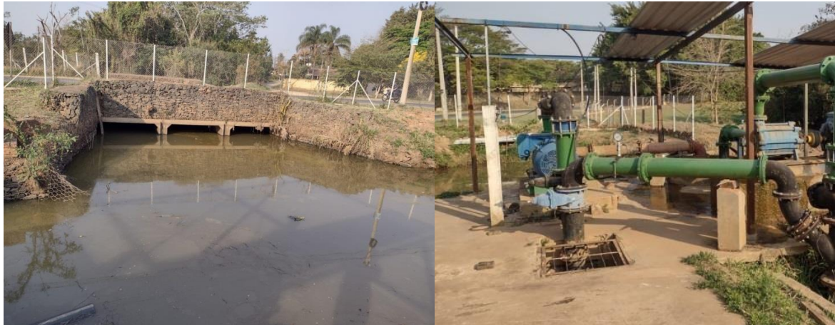
Figura: Captação e poço de sucção
