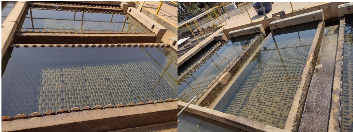
Figura: Unidades de filtração e detalhe de desnivelamento nas calhas de coleta de água decantada
