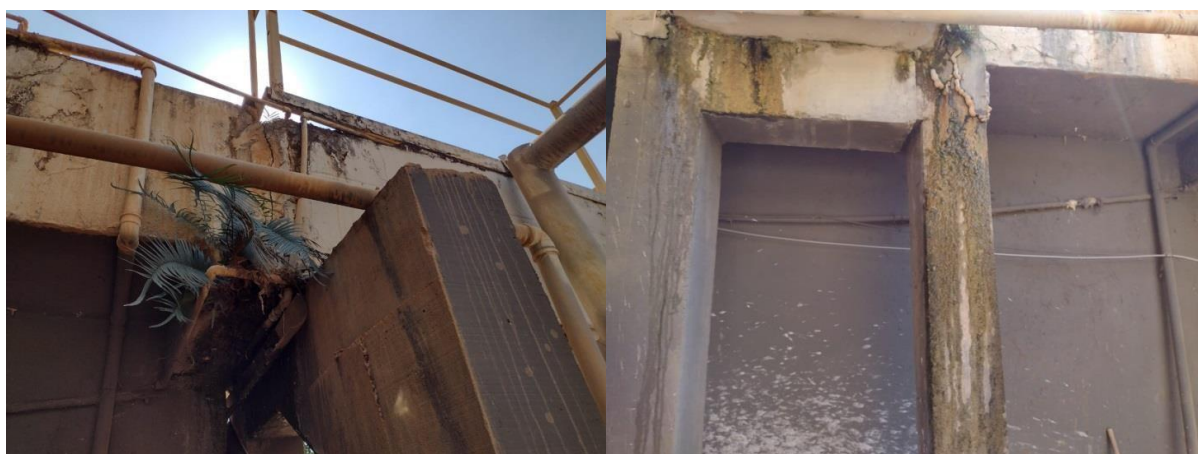
Figura: Trincas e avarias na estrutura da ETA
