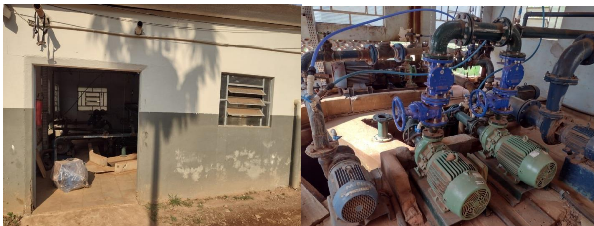
Figura: Bombas da EEAT-2 e vista externa
