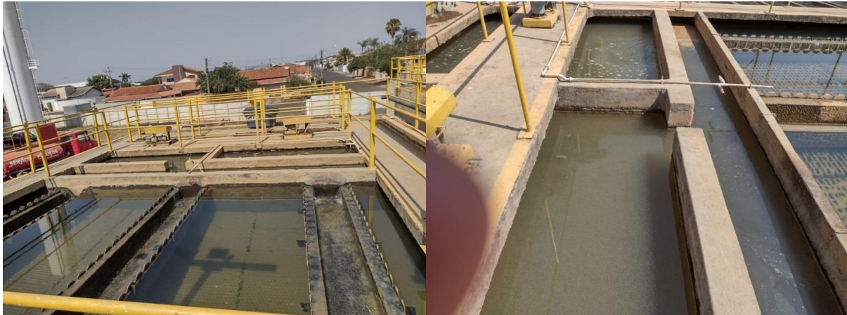
Figura: Módulos de tratamento e unidades de floculação
