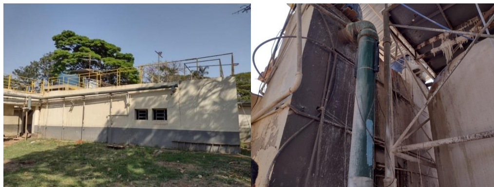
Figura: Módulos de tratamento e tubulação de água bruta na chegada
