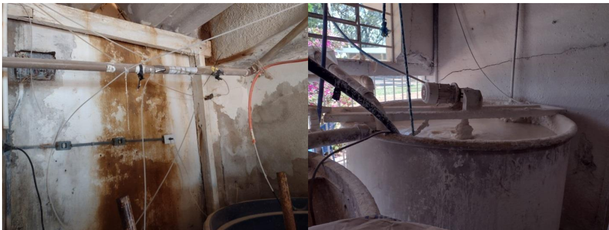
Figura: Casa de química e preparo de solução de cal
