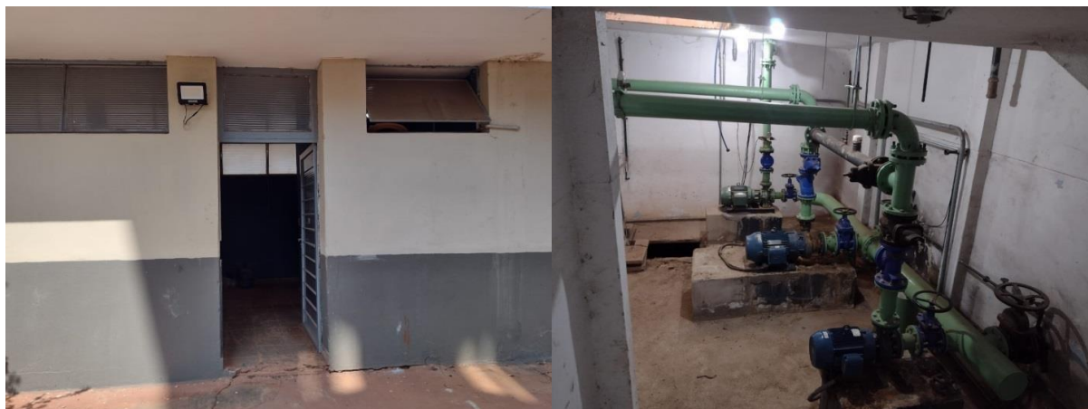
Figura: Bombas da EEAT-1 e vista externa
