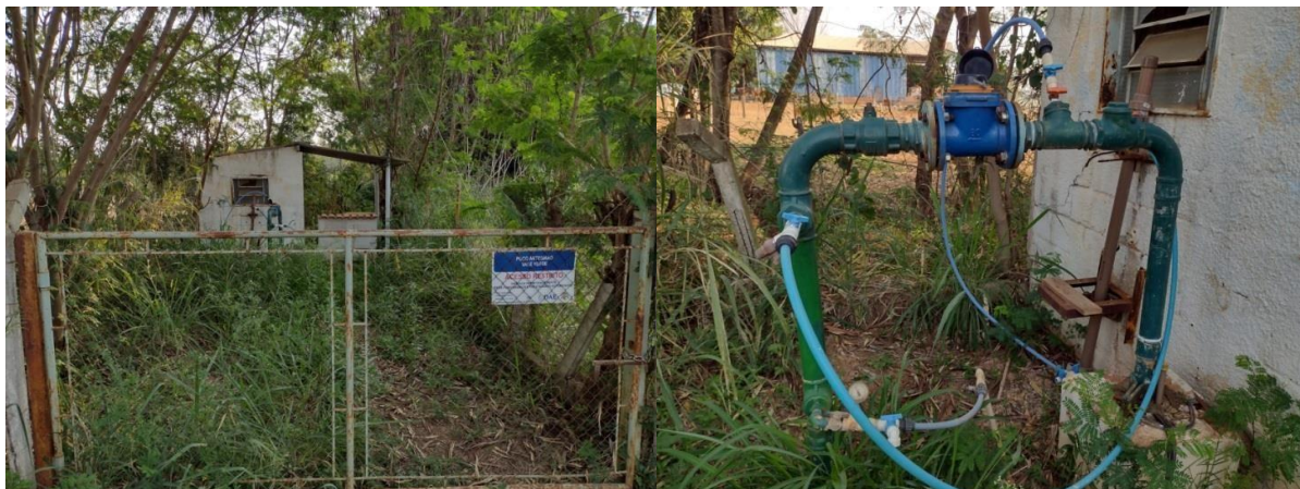
Figura: Poço Recanto Vale Verde
