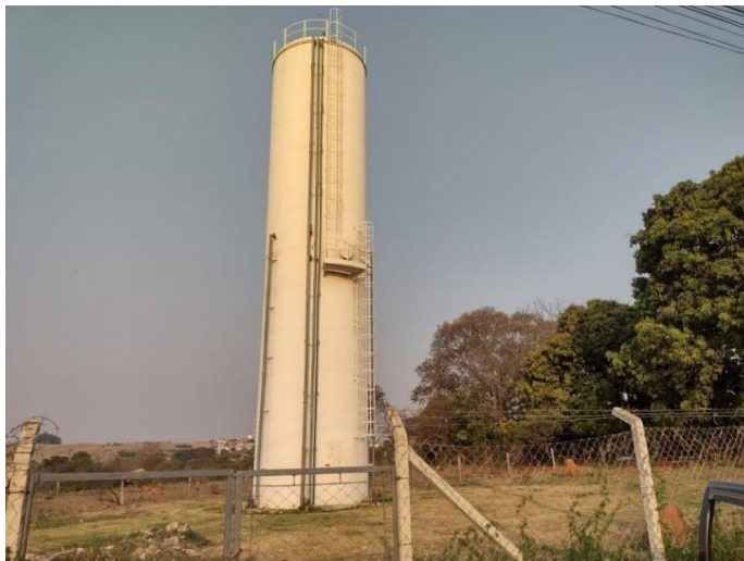
Figura: Reservatório Pe. Pedro Tomazzini 350m 3
