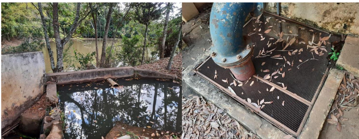
Figura: Tomada de água, gradeamento e poço de sucção
