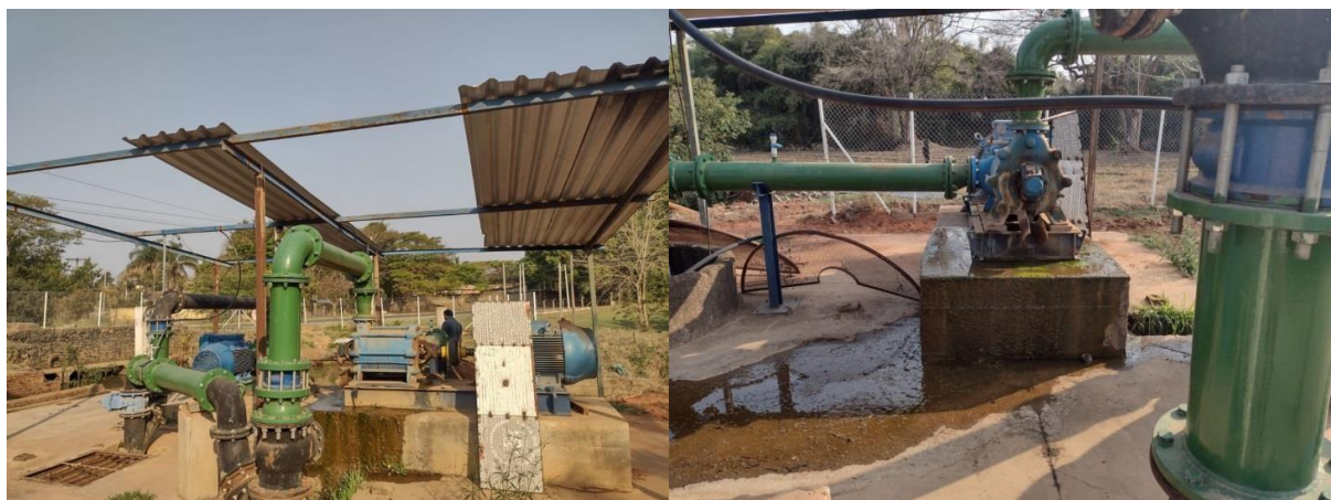
Figura: Vista da EEAB-2 e detalhe de vazamento
