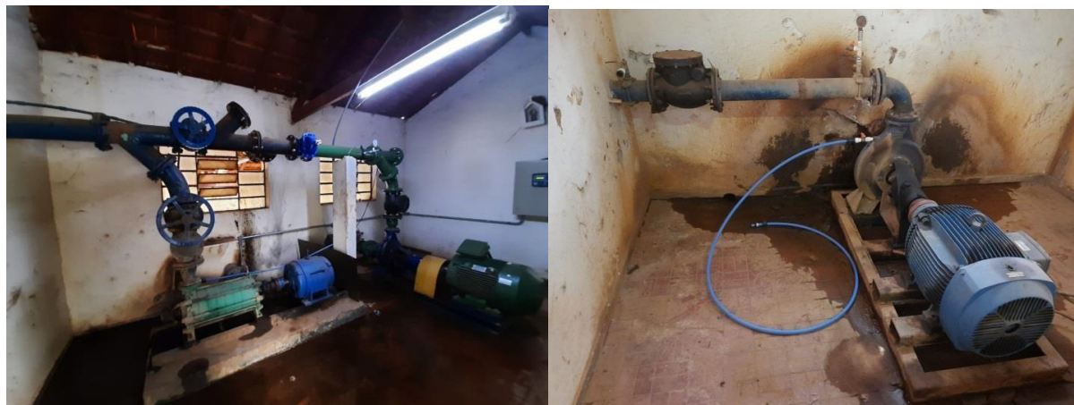
Figura: Sistema de bombeamento
