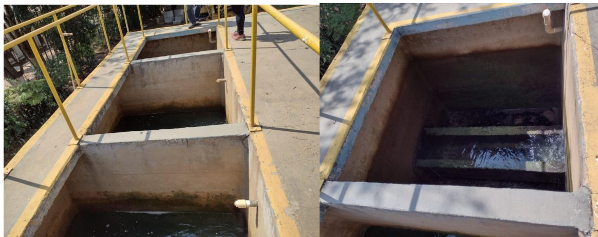
Figura: Unidades de sedimentação e detalhe de decantador
