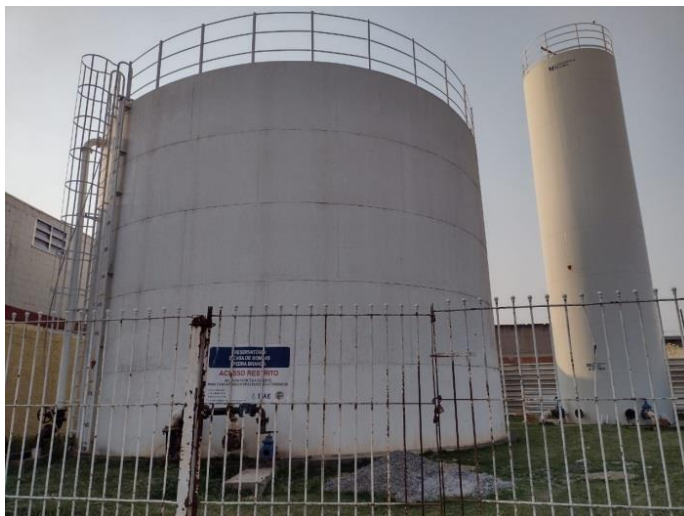
Figura: Sistema de reservação Pedra branca
